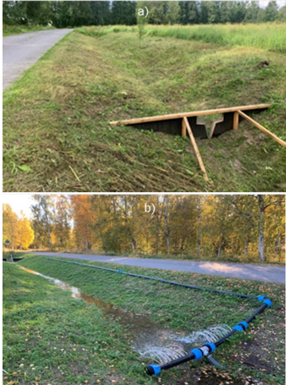
Bild 14. a) Konstruktion för utloppskontroll. b) Bevattningssystem runt försöksytan.
